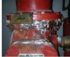
Korozyona uğramış alarm vanası
