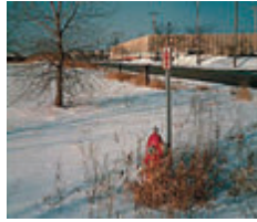
Kolayca görülmeyen konumda hidrant
