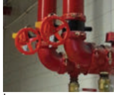
İzleme kablo bağlantıları yapılmamış kelebek vana
