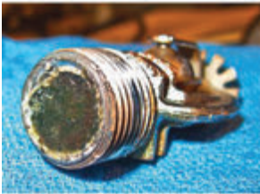
Boru içerisindeki organik veya inorganik maddelerden dolayı girişi tıkanmış sprinkler
