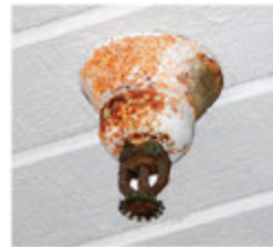
Korozyona uğramış sprinkler
