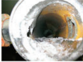
Boru içerisindeki nemden dolayı buz oluşumu.
