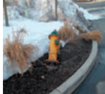
Hasar görmüş hidrant
