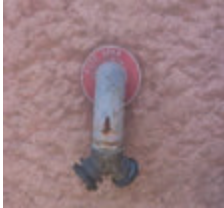
Storz bağlantıları sökülmiş itfaiye su verme bağlantısı
