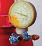
Hasar görmüş manometre
