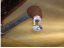
Deflektörü hasara uğramış sprinkler
