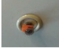
Koruma kapağı sökülmemiş sprinkler
