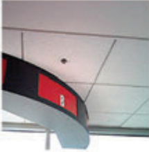
Sprinklerin su dağılımına engeller
