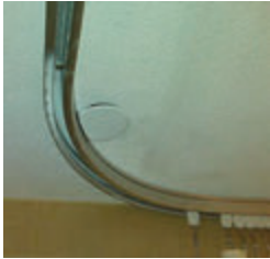
Hasara uğramış gizli tip sprinkler
