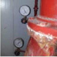
Korozyona uğramış boru ve ekipmanlar
