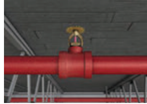
Upright pozisyonda yanlış monte edilmiş pendent sprinkler
