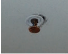
Pendent pozisyonda yanlış monte edilmiş upright sprinkler
